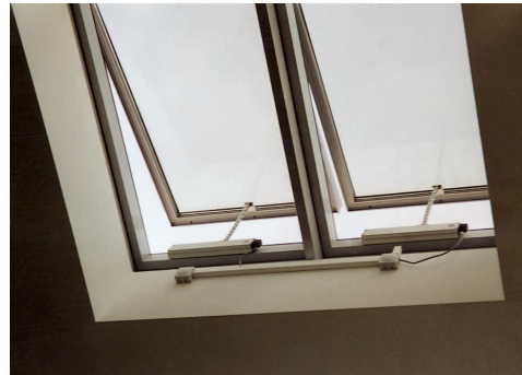
Abb. 4.6.5/25: Beispiel einer automatischen Treppenhaus-Entrauchungsanlage. Da Rauch nach oben steigt, wird das Treppenhaus weiter passierbar bleiben (Quelle: Scelsi)
